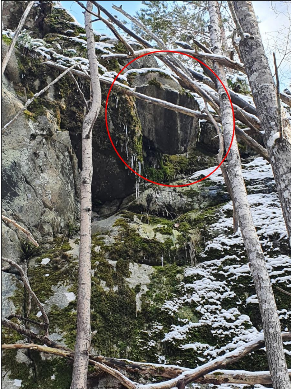
Figur 14. Åtgärd på släntdel D. Block som ska rensas är inringat med rött.
