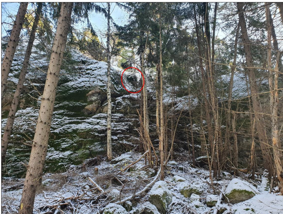
Figur 10. Åtgärd på släntdel B. Sten som ska rensas är inringad med rött.
