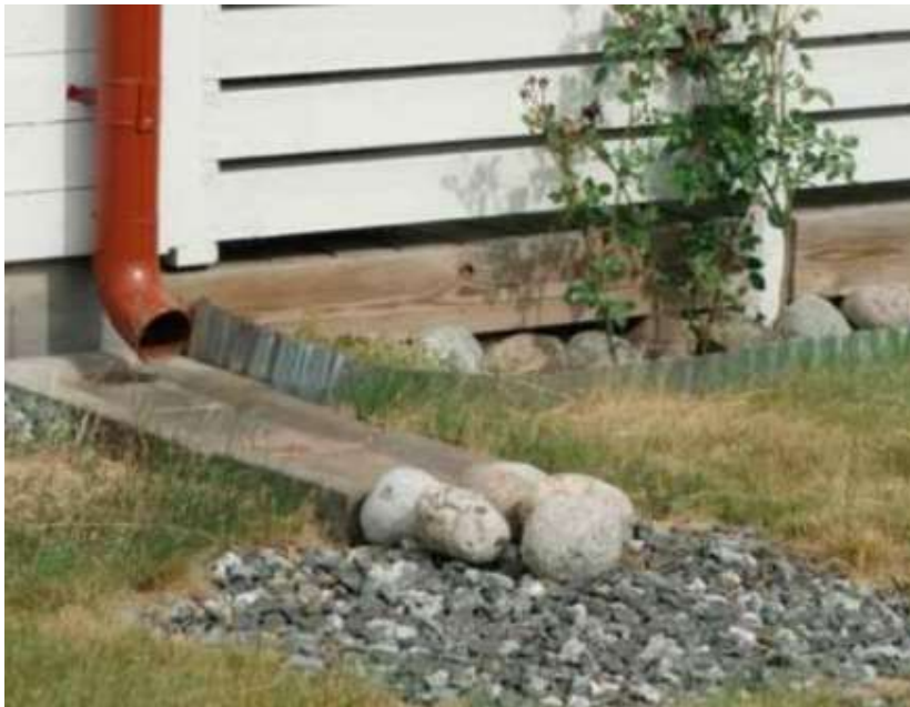
Figur 14 Stuprörutkastare med rännplattor med erosionsskydd som leder ut vattnet på gräsmatta.
