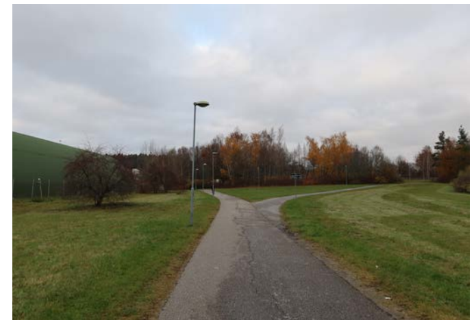
Stråk med asfaltsbeläggning som är i behov av upprustning.
