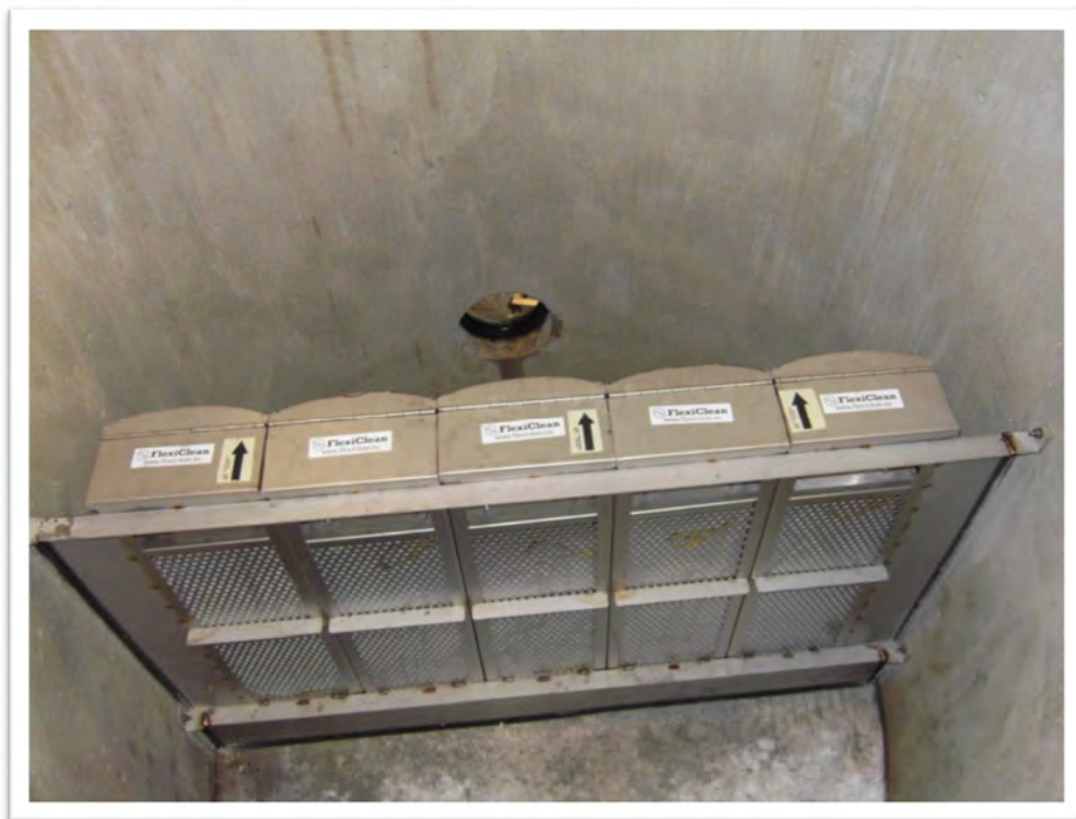
Bild 7. Filterkassetter placerade i en nedstigningsbrunn efter strypt utlopp från fördröjningsmagasin, (Flexiclean AB).
