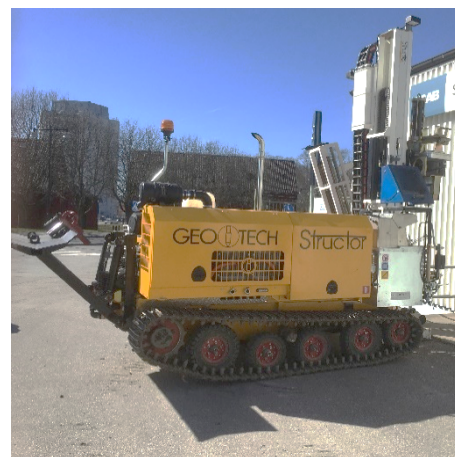
Stockholm Vatten och Avfall undersöker marken i ditt område. Arbetet görs med hjälp av en bandvagn som du ser på bilden.
